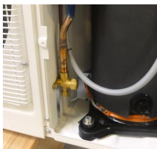
Рис 26: Сервисный порт на жидкостном трубопроводе
